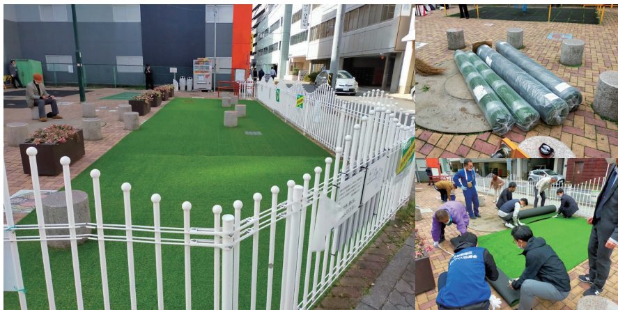
人工芝設置後の公園。ビル街に緑空間が登場 上:ロール状の人工芝 下:設置作業風景
